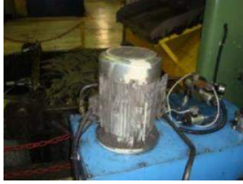
Soğutma Kulesi Motoru
