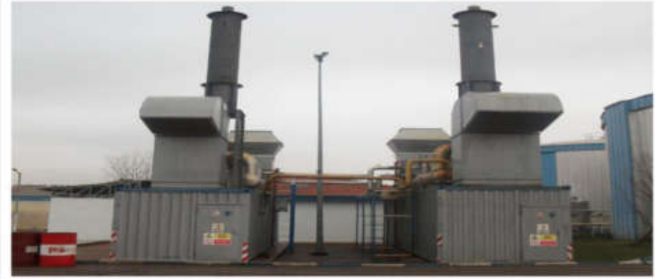
1,6 MW GASKİ KOJENERASYON TESİSİ
