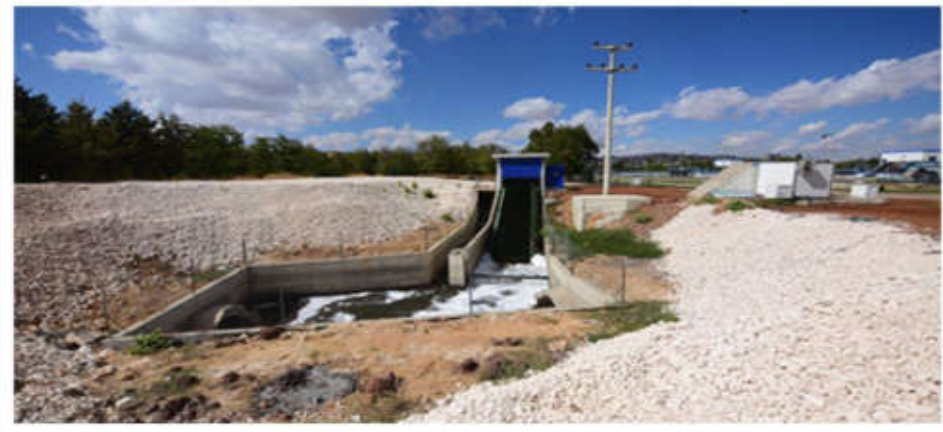
170 KWH GASKİ ARŞİMET BURGULU ENERJİ TESİSİ
